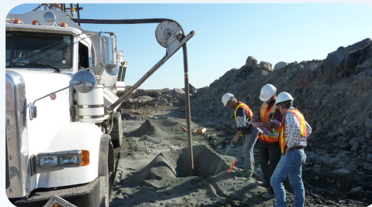
TITAN 1000ΔE camión fábrica equipado con tecnología y controles automatizados
